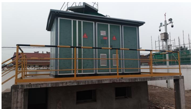
10KV 箱式变电站
