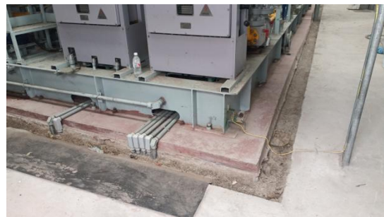
混凝土减振基座
