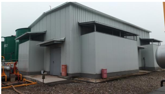
压缩机组降噪房
